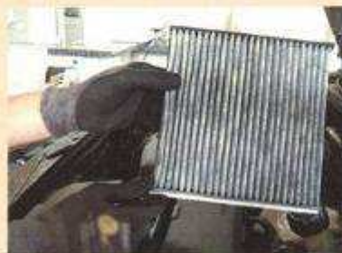
Remplacement d'un filtre à climatisation
